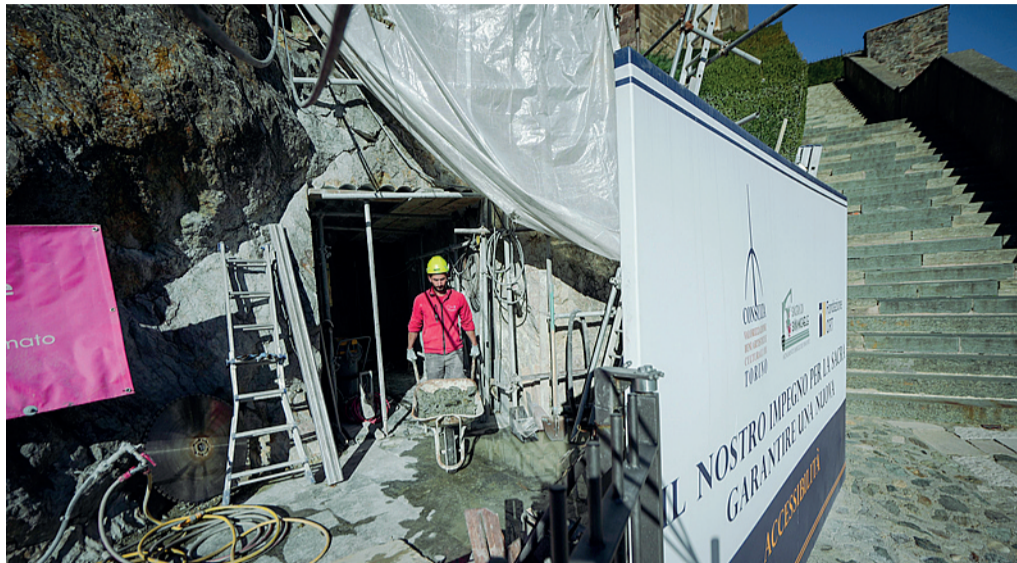
Lavori in corso Lo scavo nella roccia per la costruzione dell'ascensore che renderà la Sacra accessibile a tutti
